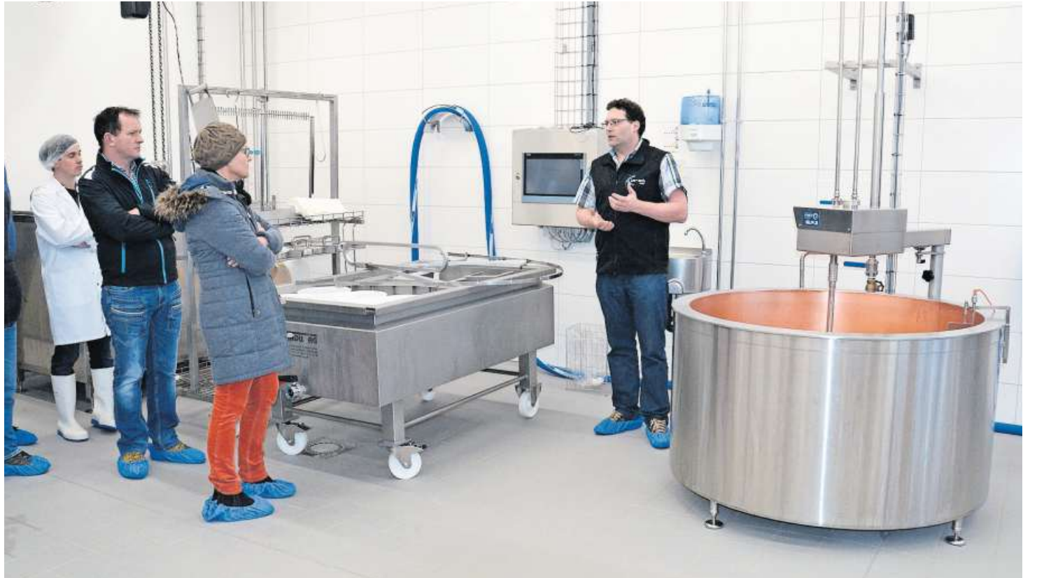
Fachplaner Jann Walder (ganz rechts) erklärt die technische Einrichtung der neuen Schulkäserei.
